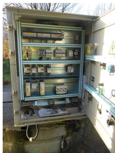
Armoire de commande
