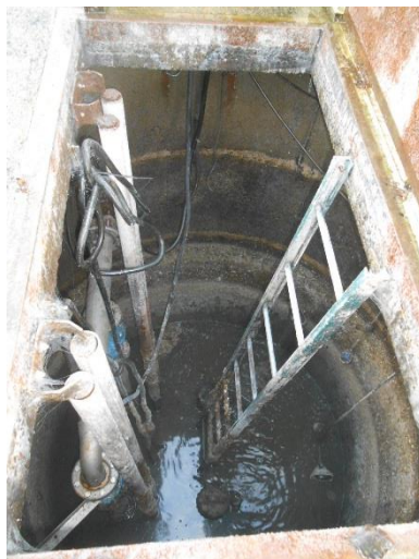
Poste de relevage
