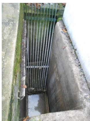
Canal de dégrillage
