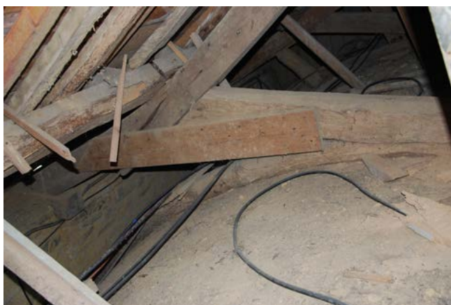
Arbalétrier Sud cassé, déjà renforcé par des moises en sapin chevillées. Il n'y a pas de traces de mouvement depuis le renforcement.
