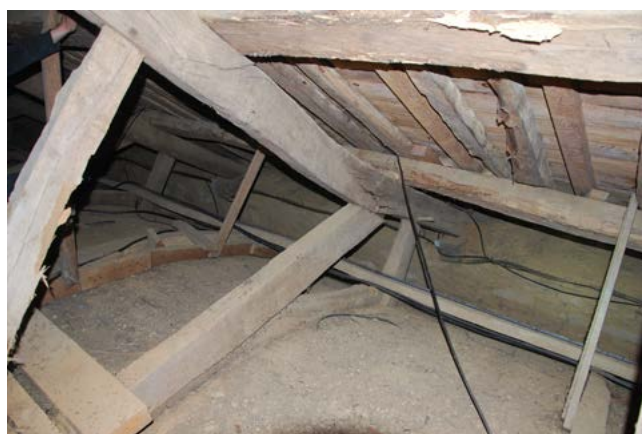
Arbalétrier Sud cassé, non renforcé.
