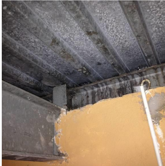
Figure 8 - Salpêtre sur le mur et sous le bas acier
