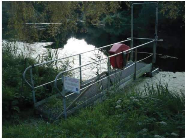
Prise d'eau – retenue de Milin Izella
