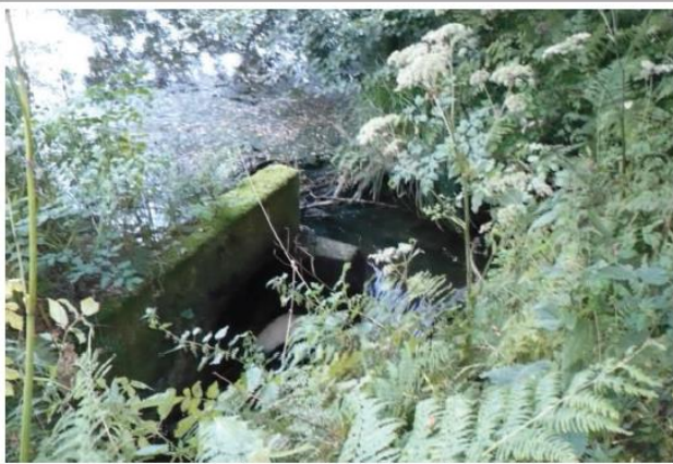
Réserve intermédiaire – trop plein
