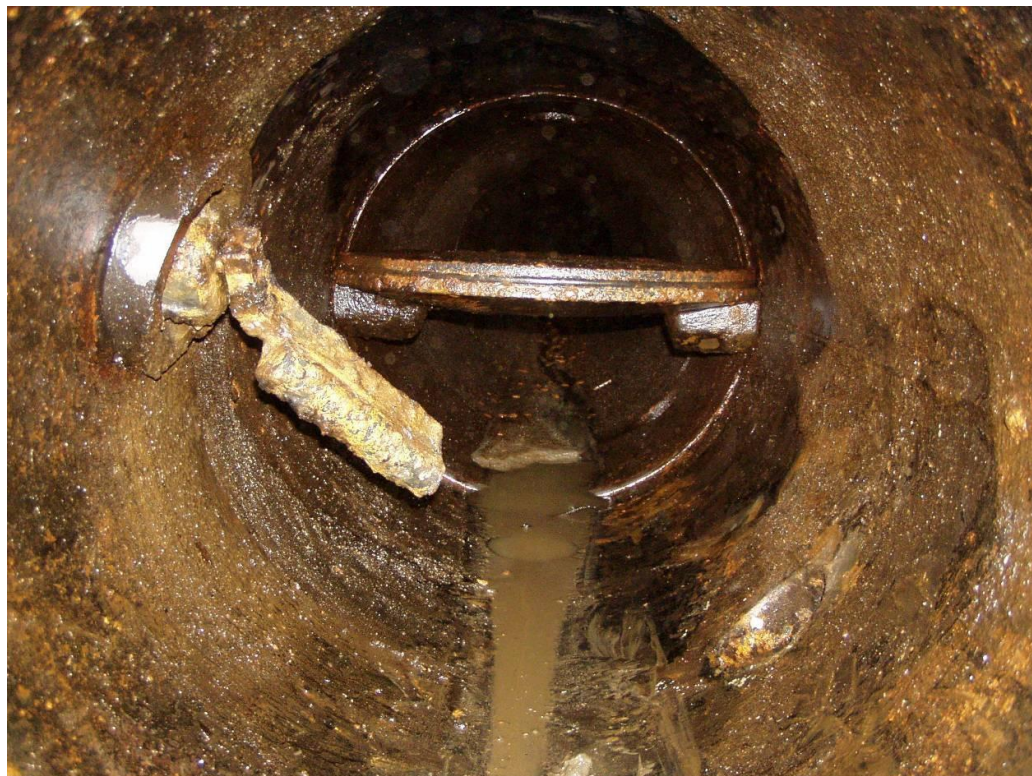
Photo 10 : Vanne de survitesse et conduite de prise DN800
