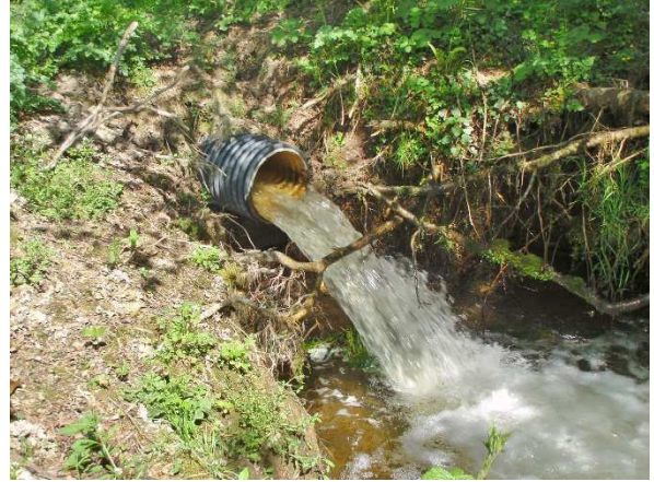
Chute d'eau > 1 m en aval
