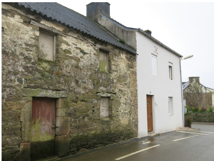
Plusieurs bâtiments dégradés en coeur de bourg (13)
